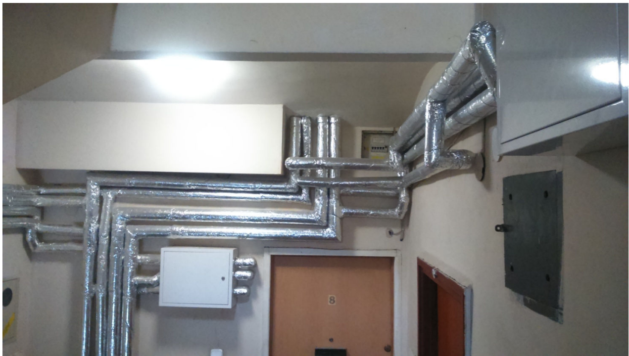
Ciepłomierz lokalowy zamontowany w skrzynce pomiarowej. Na zdjęciu widoczne także rury doprowadzające czynniki grzewczy do ciepłomierza lokalowego oraz rury doprowadzające ciepło do lokalu. Rozwiązanie alternatywne
