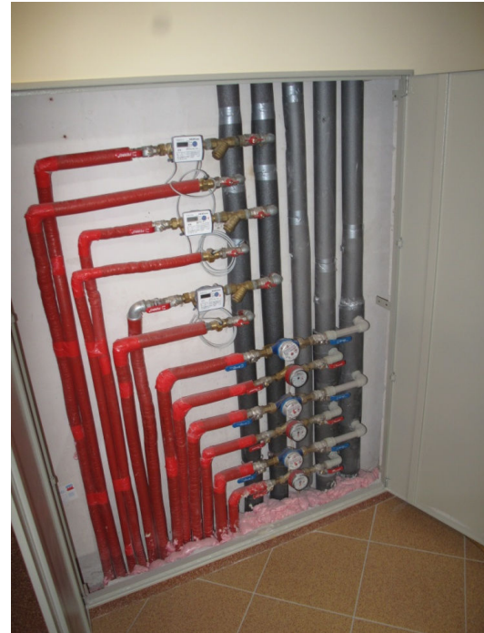
Ciepłomierze lokalowe zgrupowane dla 3 szt. lokali znajdujących się na tej samej kondygnacji.
