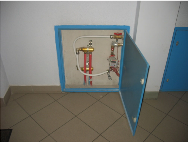
Ciepłomierz lokalowy w skrzynce pomiarowej usytuowanej na klatce schodowej budynku.
